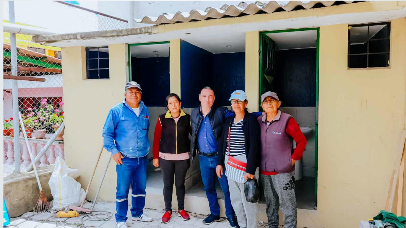
Trabajos de colocación de cerámica e instalación de baterías sanitarias en la casa comunal del barrio San Juan Loma .
